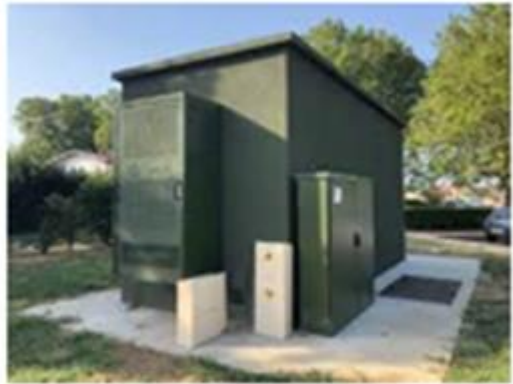
NŒUD RACCORDEMENT OPTIQUE (NRO)
